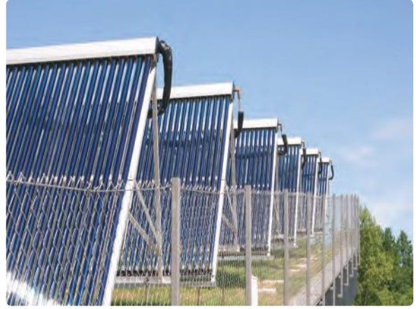
4.12: Güneş Enerji Sistemleri
